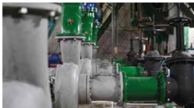
De grootste energieverbruikers zijn de motoren in de gemalen die de pompen aandrijven. Van de totale energie die een gemaal verbruikt nemen ze 95 procent voor hun rekening.
